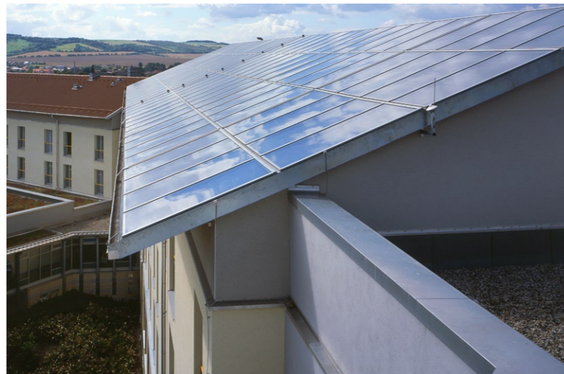
Grote thermische zonne-energie-installatie op het dak van een revalidatiekliniek voor verwarmd tapwater, verwarming en zwembad
